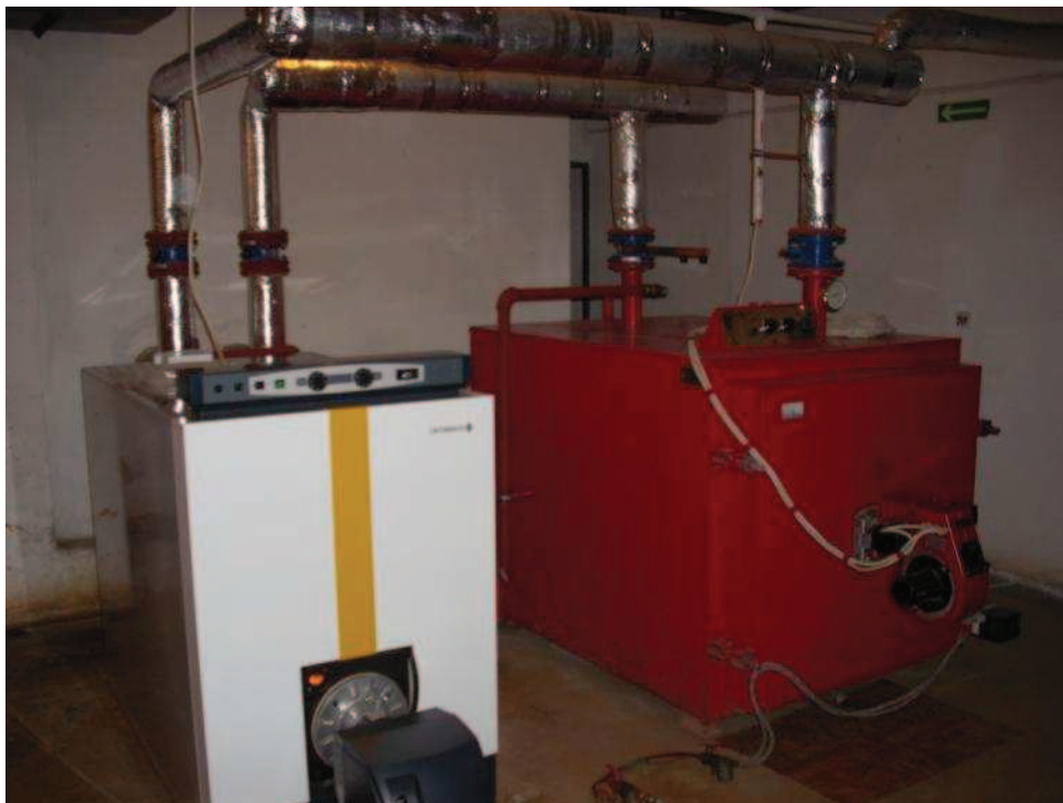
Kotły olejowe CO
