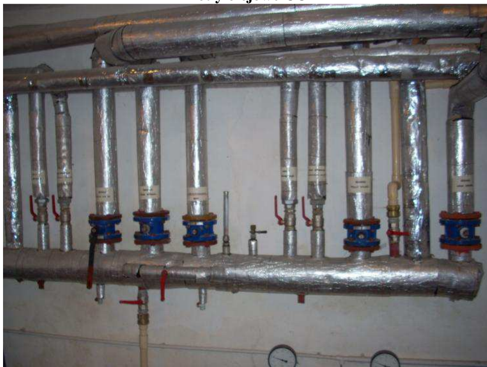
Węzeł cieplny CO i CWU
