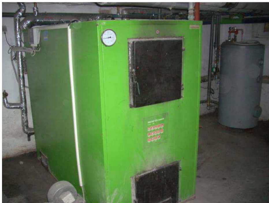
Kocioł na paliwo stałe mocy 103 kW
