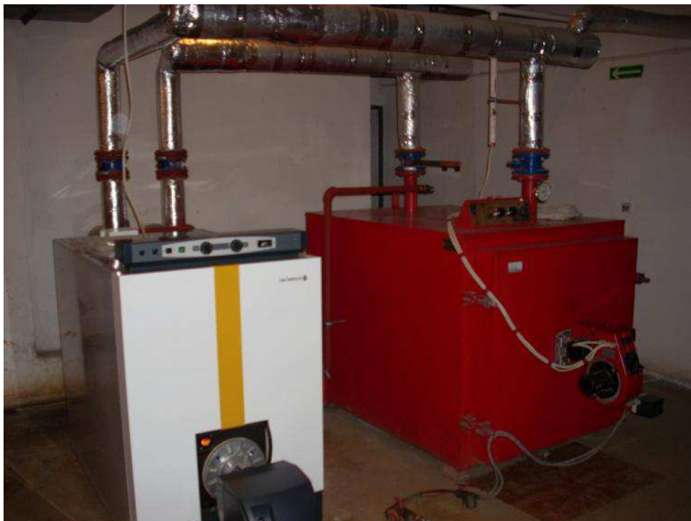
Kotły olejowe CO
