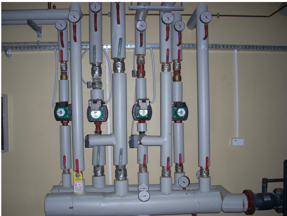
Rozdzielacz wody grzewczej hala sportowa
