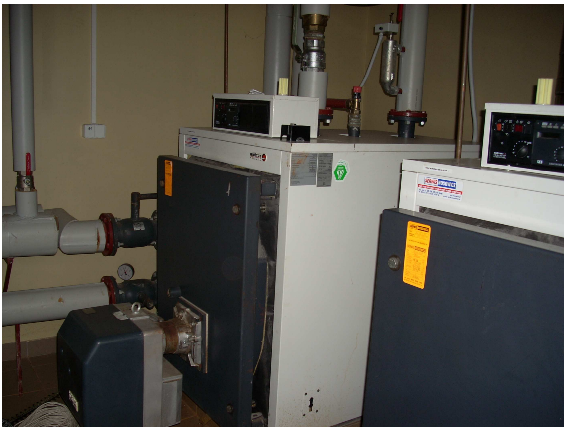
Kotły olejowe o mocach 180 kW
