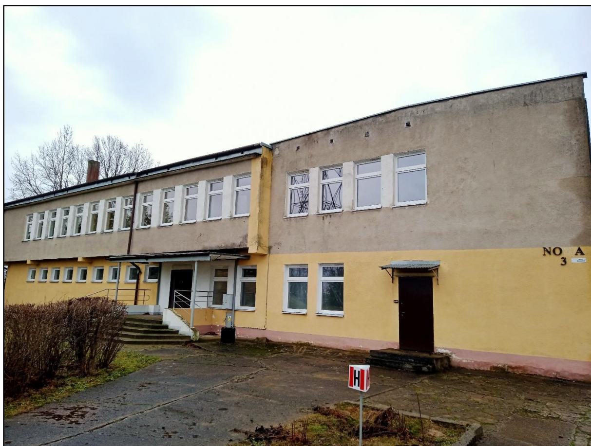
Rycina 15 Przykład przestrzeni wymagającej poprawy stanu technicznego na obszarze rewitalizacji – były budynek straży granicznej
